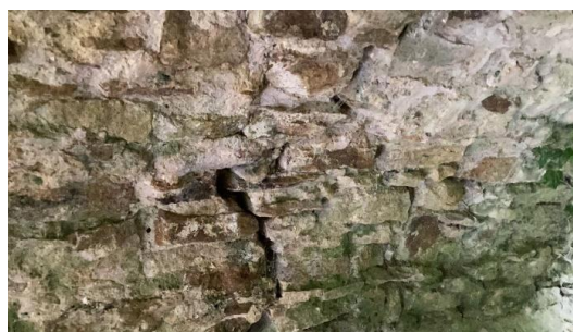
Fracture de la douelle
