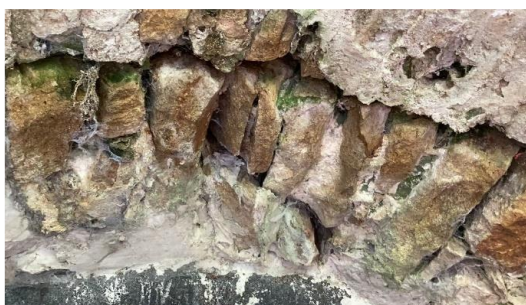
Disjointements et perte de matière
